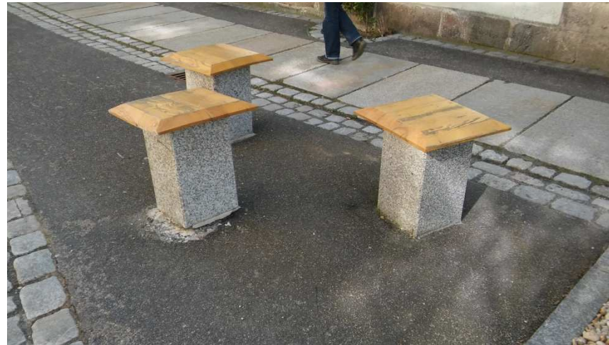
Foto 37: Teilweise vandalierte Straßenmöblierung in der Schloßstraße
