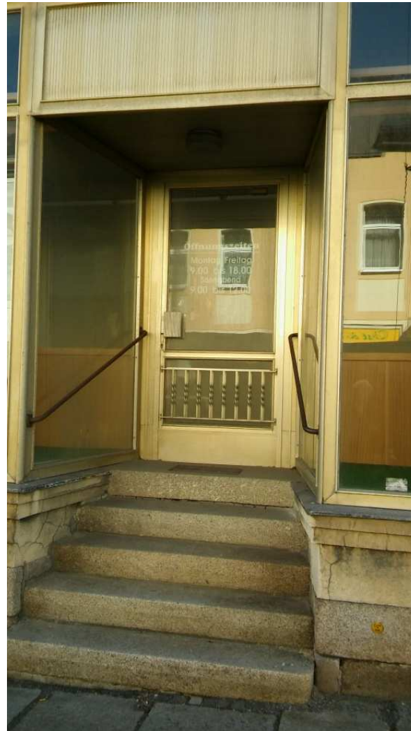
Foto 51: Treppenstufen im Eingangsbereich eines brachgefallenen Geschäftes in der Hauptstraße
