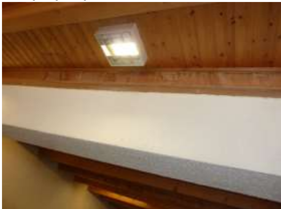
Feuchtigkeitsspuren in Bereich der Holzbalken (Decke)
