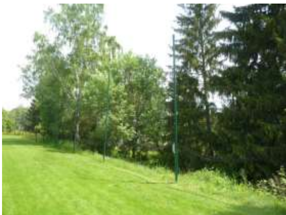
Ballfangpfosten neigen sich auf der OK der Böschung
