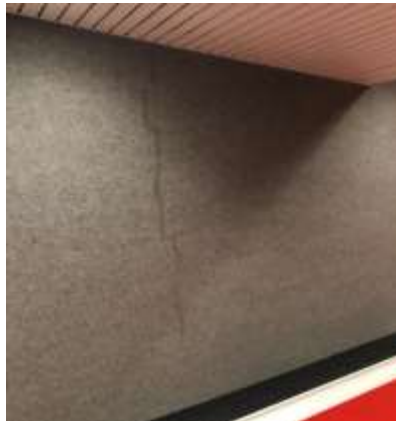
Risse unter dem Nadelvlies an der Wand zur Mehrzweckhalle
