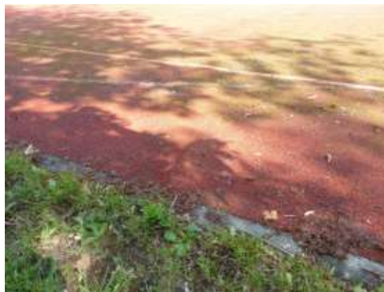
Unebenheiten und Risse im Kunststoff aufgrund der Baumwurzeln
