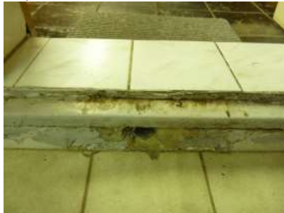
Schäden an den Fliesen und im Bereich der Türe/Schwelle
