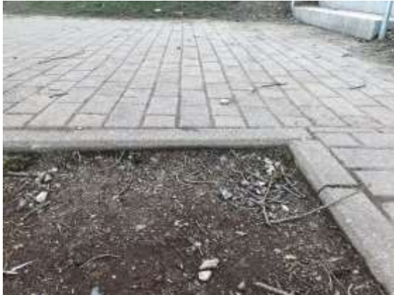
Sportbelag mit Steinen und Ästen durchsetzt; niedrig
