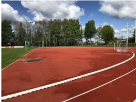
Nordsegment, fehlender Stoßbalken an der Kugelstoßanlage
