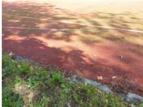
Unebenheiten und Risse im Kunststoff aufgrund der Baumwurzeln
