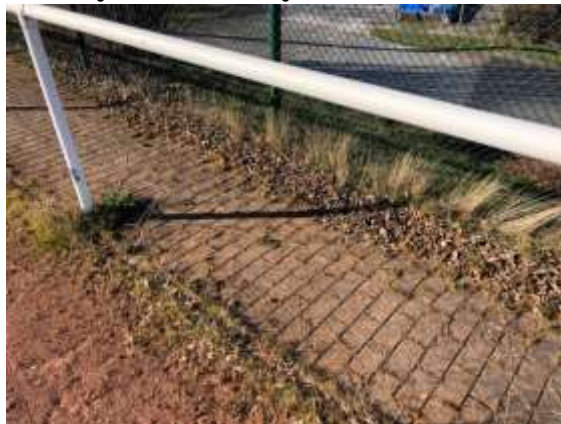
Pflasterbereich und Stahlbarriere, Unkrautbewuchs.
