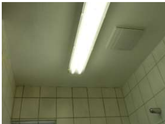
Verschmutzte Fugen und Schimmelspuren im Sanitärbereich
