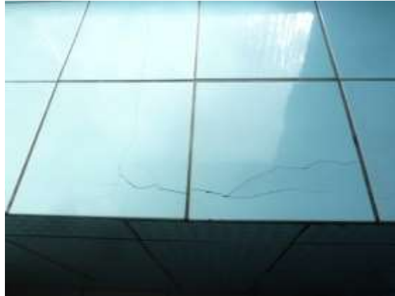
Risse an den Fliesen - Fensterstock
