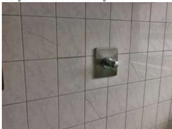
Gerissene Fliesen an der Duschwand der Jungen
