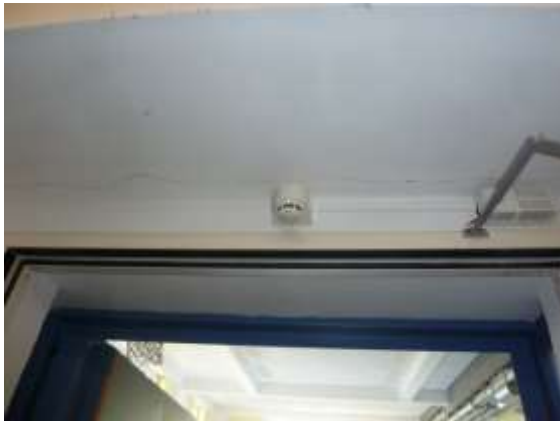
Riss im Bereich des Türsturzes zum Geräteraum
