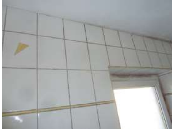
Schimmel in Fensterleibungen, an Fugen und an der Decke
