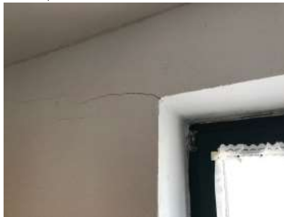
Wandrisse Fensterecke WC
