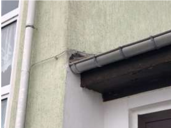
Dachtaufe / Gebäudeanschluss vereinzelt schadhaft
