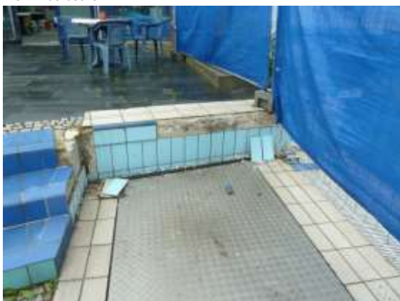
Eingangsbereich, schadhafte Fliesenflächen
