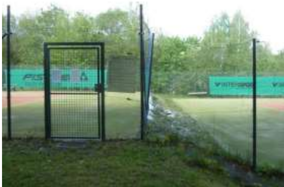
Zaunpfosten neigen sich an der OK Böschung zwischen dem oberen
