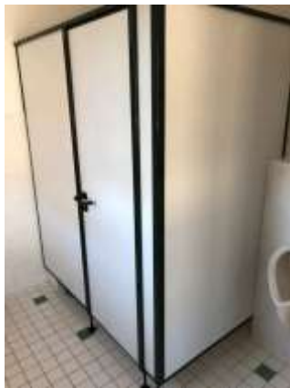
WC mit Sanitärtrennwänden
