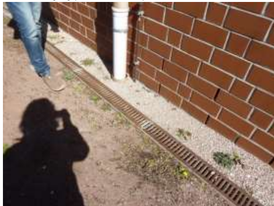
Entwässerungsrinne (etwas zu hoch – Pfützenbildung) und Kiesstreifen
