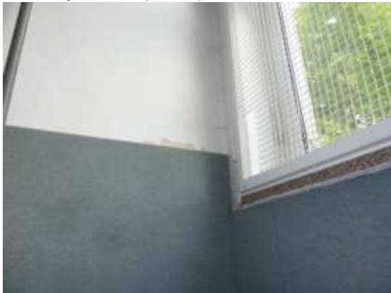
Putzabplatzungen am Abschluss der textilen Prallwand
