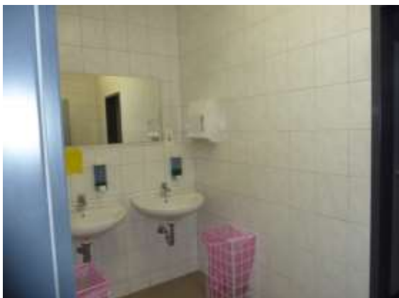
Waschbecken der WC-Anlagen
