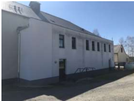
Anbau für Fahrstuhl und Treppe / Nordfassade mit Algenwachstum
