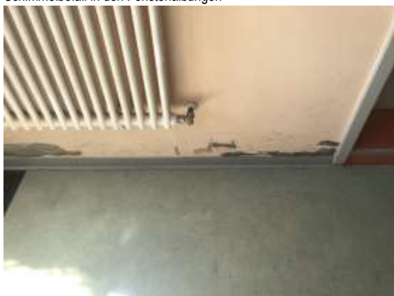
Putzabplatzungen Sockelbereich Flur (EG)
