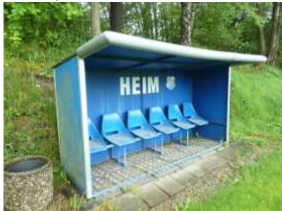
Kabine, Gehwegplatten liegen lose
