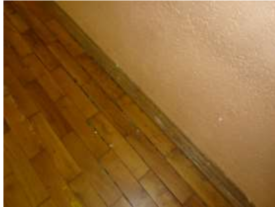
Risse im Parkett durch Unebenheiten am Wandanschluss
