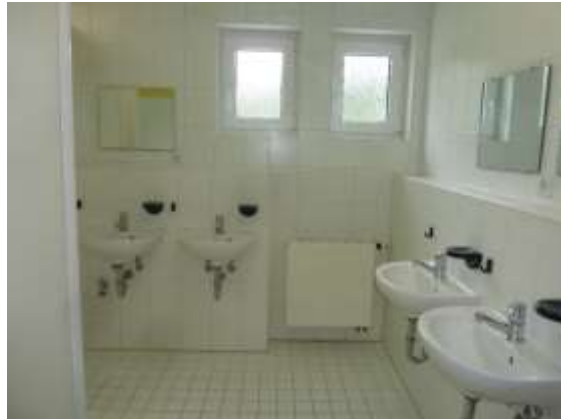
Sanitärbereich mit Waschbecken, Duschen und WC
