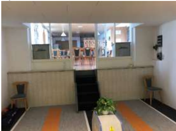
Höhenversatz zwischen Kegelbahn und Keglerstube
