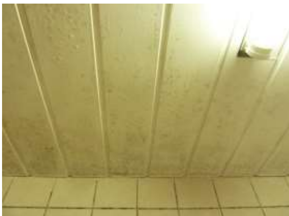
Schimmelspuren an der Decke und Verfärbungen in den Fugen
