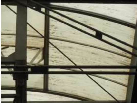
äußere PVC-Platten im Dachlichtband durch Hagel beschädigt
