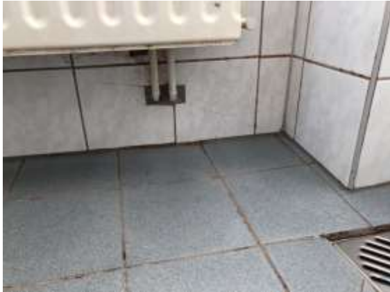
Schäden und Abnutzungsspuren
