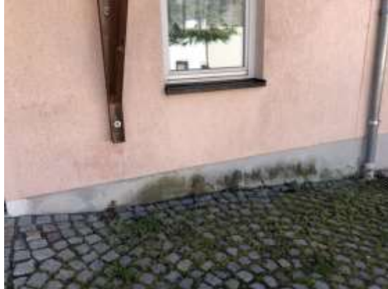
Nässe, bzw. aufsteigende Feuchte im Sockelbereich
