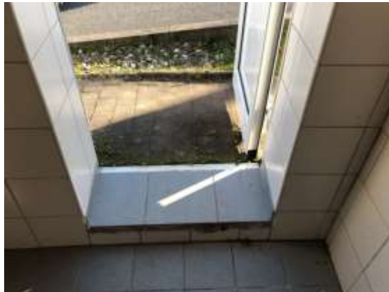
nicht Behindertengerecht (Türschwelle Besuchertoiletten)
