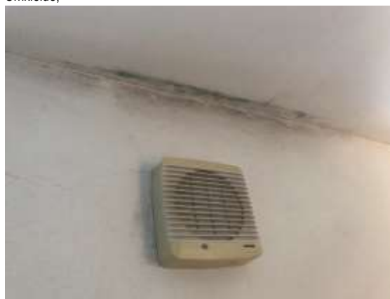
Wandlüfter Sanitärraum – am Deckenanschluss Schimmelspuren
