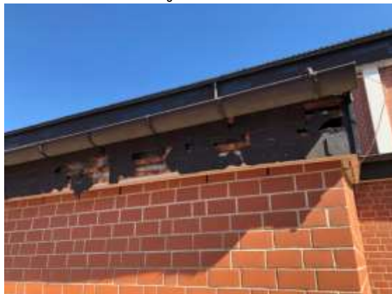
Schäden im Traufbereich an der Außenwand des Kegelbahnbaus
