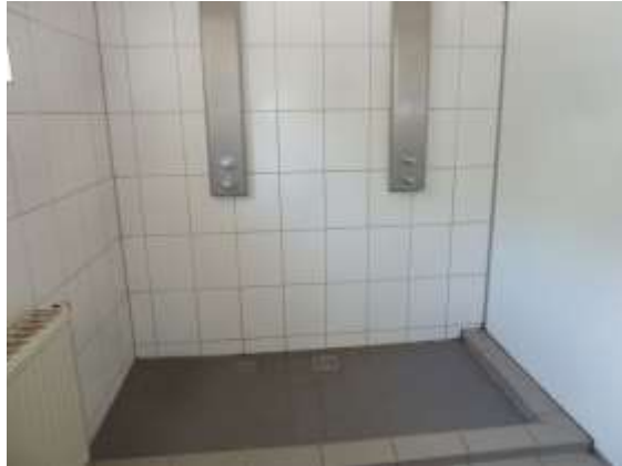
Duschbereich, Verfärbung der Fugen (Schimmel)
