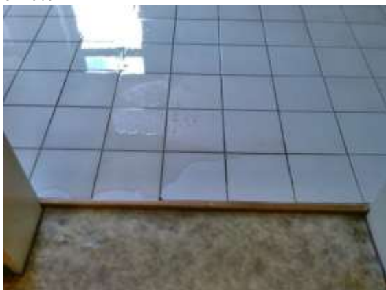
Nässe nach dem Duschen im gesamten Sanitärbereich
