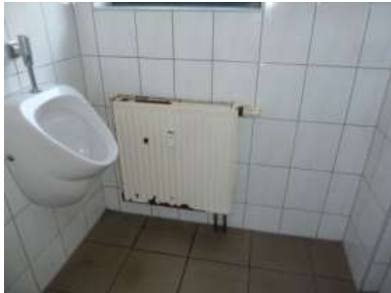
WC-Herren (Alter ca. 30 J.), Heizkörper verrostet
