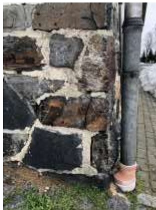
Risse im Gebäudesockel
