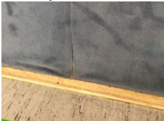
Schäden an der Prallwand, Stöße der Bahnen
