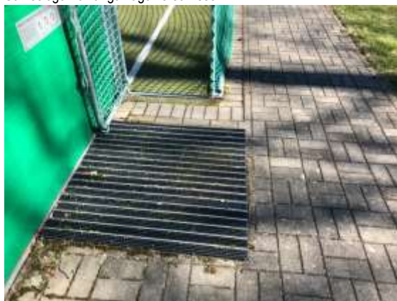
Moos- und Unkrautbewuchs auf der Pflasterfläche
