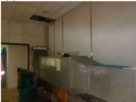
Zugang mit Lüftungsanlage
