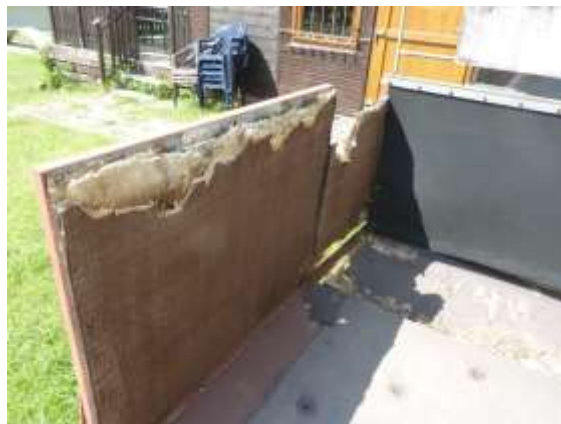
Aufstellbereich – Boden eingebrochen
