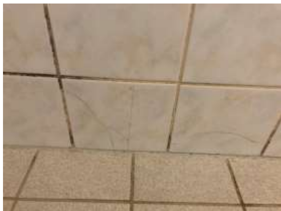
Gerissene, gebrochene Fliesen
