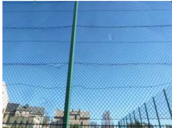
Schadstellen im Maschendraht der Ballfanganlage
