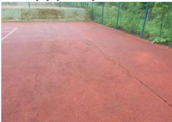
Risse und Vermoosungserscheinungen in den Randbereichen
