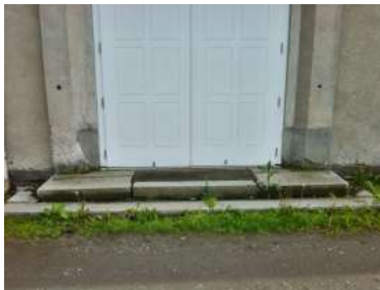
Podest am Notausgang zu klein und sanierungsbedürftig
