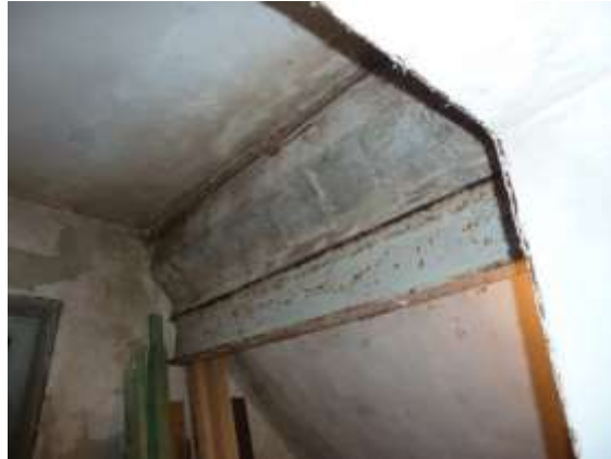
Rost und Feuchtigkeit unter der Zugangstreppe
