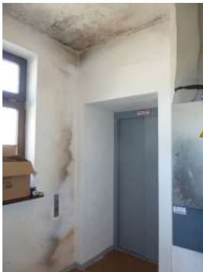
Schimmelbefall im Anbau für Fahrstuhl (OG)
