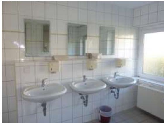
Waschbecken im Sanitärbereich
