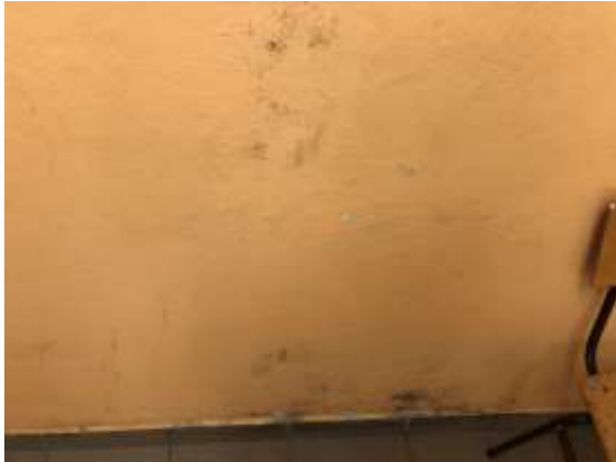
Schimmelspuren im Umkleebereich 2
