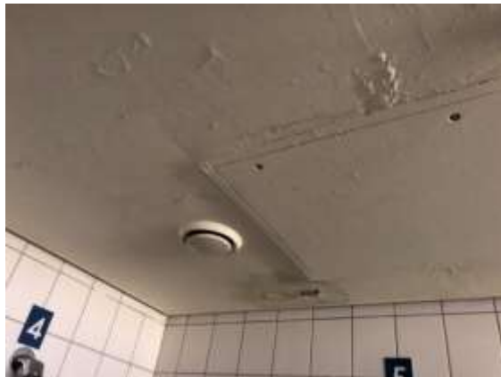
Schäden und Schimmelbildung an Decke im Duschbereich
