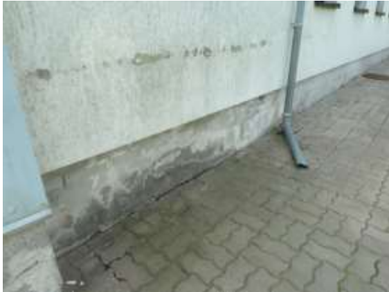
Feuchtigkeitsspuren im Sockelbereich
