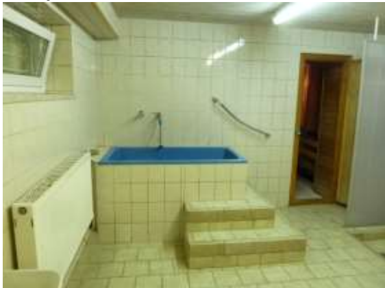
und Tauchbecken für die Sauna
