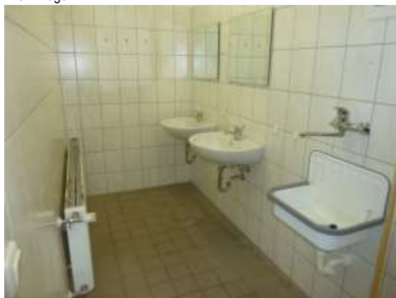
Waschbereich mit fehlendem Bodenabfluss
