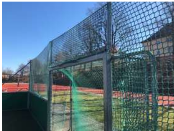
Stirnseitige Ballfanganlage verschlissen
