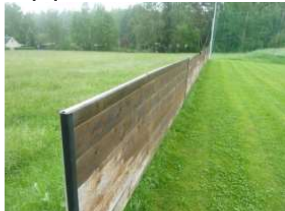
Alte Band mit Werbung zur Straße hin (Feuchtigkeitsschäden)
