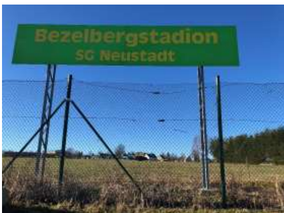
Grundstückszaun, stellenweise schadhaft
