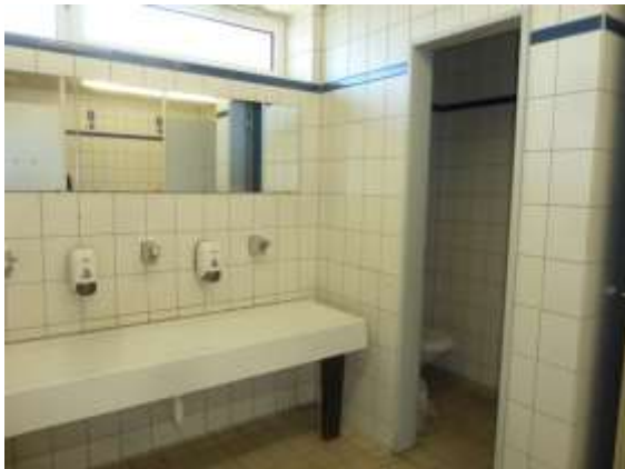
Waschbereich und WC unsaniert
