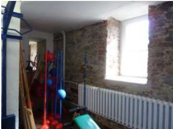
Putzabplatzungen, Rostspuren an der Heizung und fehlende Lagerfläche
