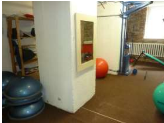
Feuchtigkeitsspuren im Sockelbereich der Stützen (Putzabplatzungen)
