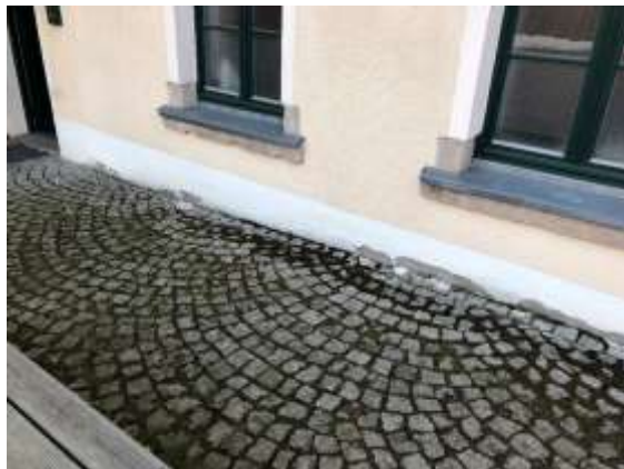
Nässe, bzw. aufsteigende Feuchte im Sockelbereich
