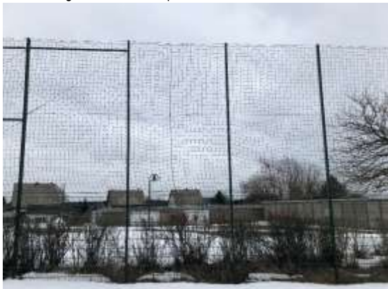
Ballfangnetzanlage Richtung Parkplatz
