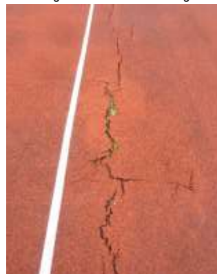
Risse stellenweise mit Unkraut bewachsen
