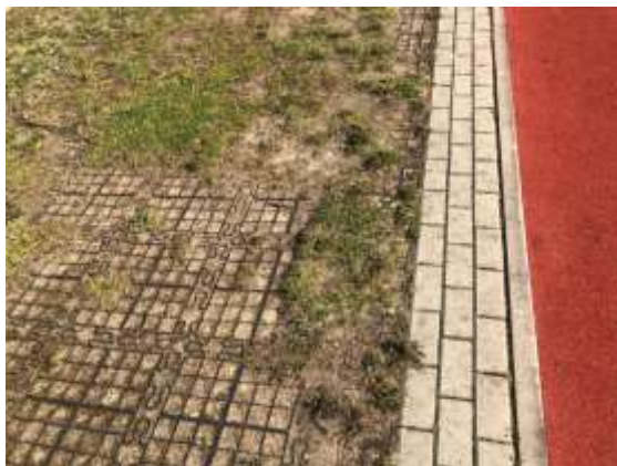
Geogitter, schlechter Rasenwuchs
