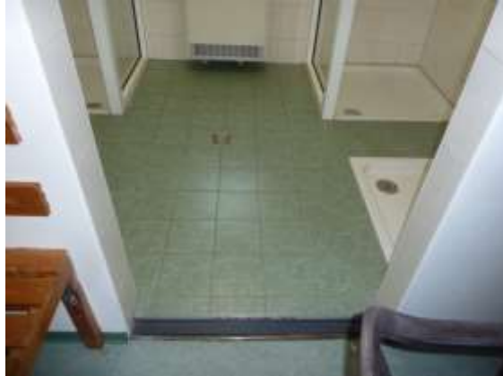
Spritzwasserproblematik im Schwellenbereich
