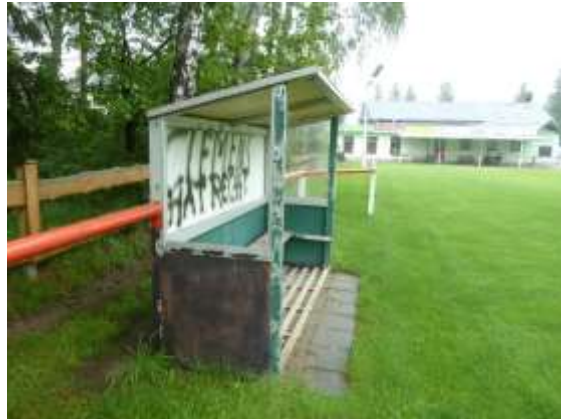
Kabinen sind schon älter und sanierungsbedürftig
