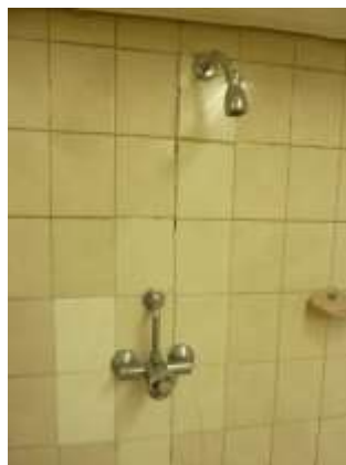
Schäden im Fliesenbereich
