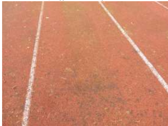
Vermoosungserscheinungen, oberste Deckschicht fehlt stellenweise
