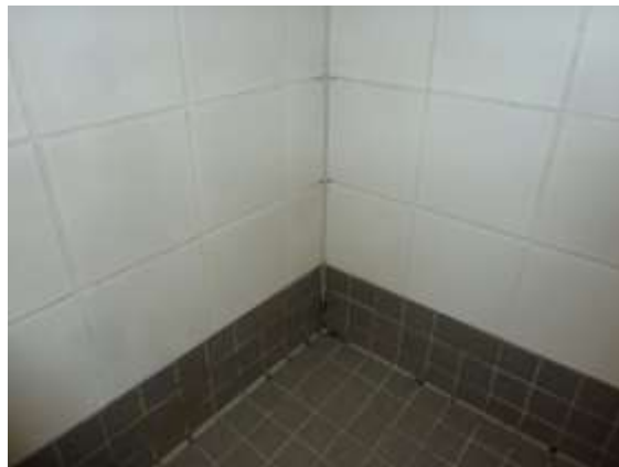
leichte Schimmelspuren in den Eckbereichen der Fugen
