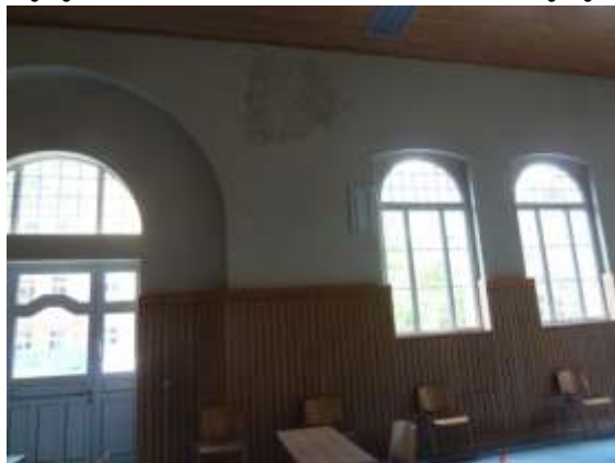
Notausgang, Nässeschaden im Wandbereich
