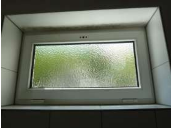
Schimmelbildung am Fenstersturz
