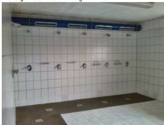
Duschraum für alle Umkleiden, Lüftungsanlage unterdimensioniert
