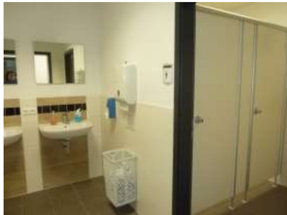
WC-Anlagen für Gäste vom Flur aus
