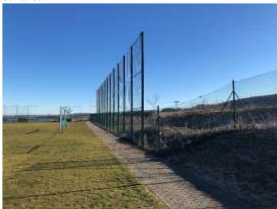
Ballfangzaunanlage hinter 16m-Raum
