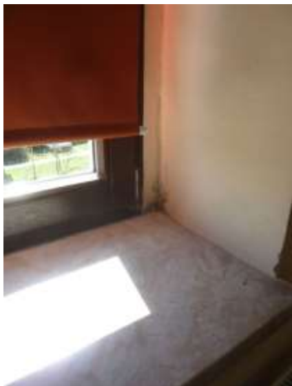
Schimmelbefall in den Fensterlaibungen
