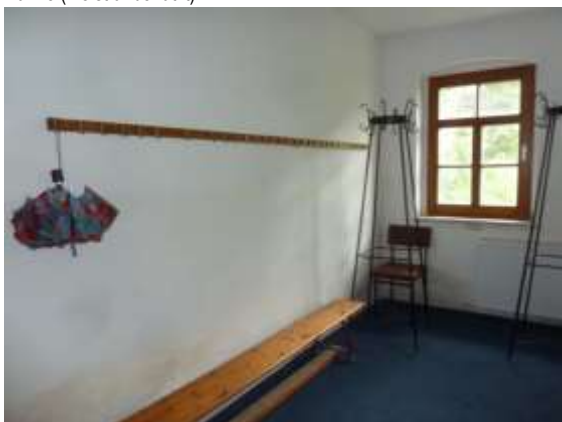
Umkleide EG, Feuchtigkeitsschäden an der Innenwand
