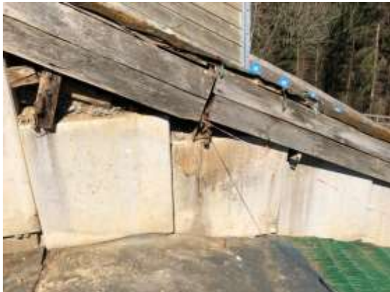
Schäden an der Winkelstützwand K 45
