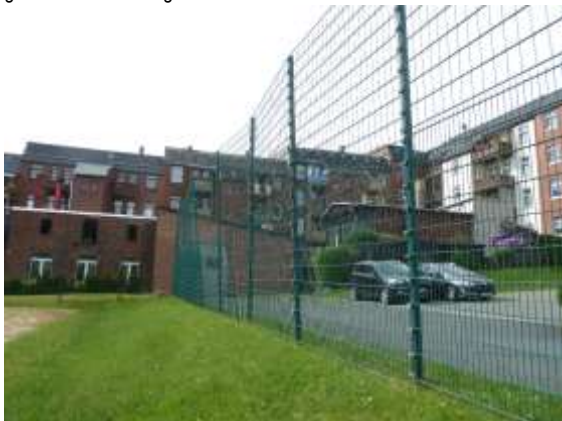
Zaunanlage mit Schiefstellung Pfosten
