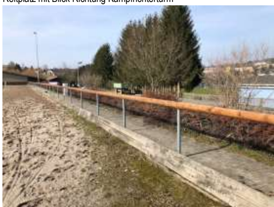
Holzholme (erneuert) und teilw. verwittertes Fußholz.
