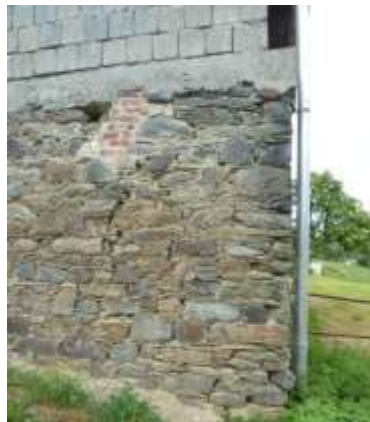
Risse im Bereich der Ecke von Innen und Außen
