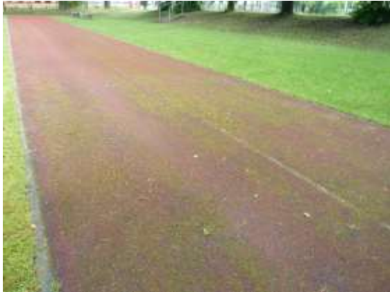
Anlaufbahn Weitsprung mit Vermoosungserscheinungen
