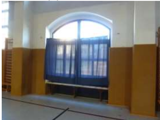
Ehemaliger Hauptzugang, verstellter Notausgang!
