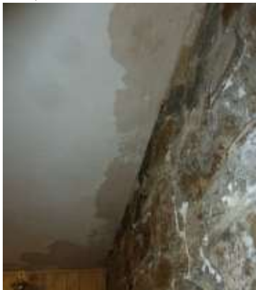
Feuchtigkeitsspuren an der Decke zur Außenwand
