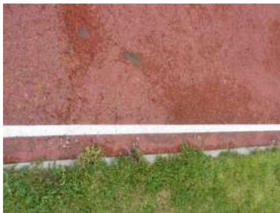
Kunststoff mit leichten Rissen im Randbereich
