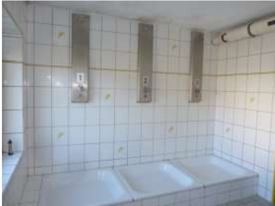
Duschen mit Schimmelbefall aufgrund unterdimensionierter Lüftung
