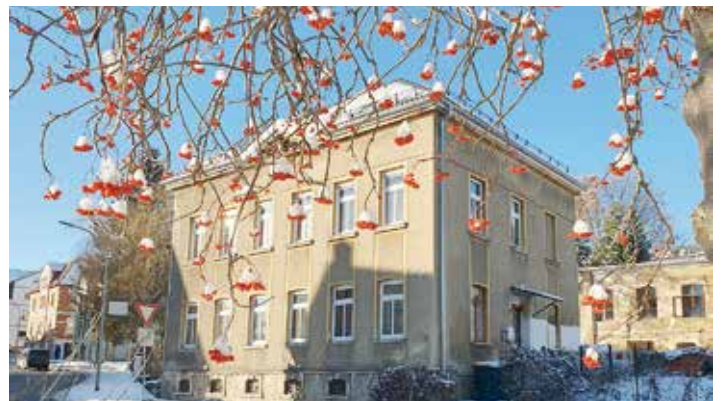
Stetig geht der Innenausbau voran, Wände und Decken erhalten neues Antlitz, Haustechnik und Elektrik werden Schritt für Schritt installiert.
