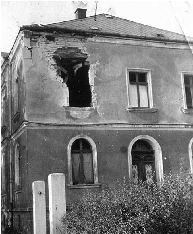
Schaden durch Granaten-Einschlag am Gebäude Lindenstraße 16. (Foto: Wolfgang Thoss)
