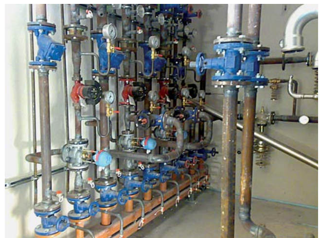
Verteiler-Station für die Heizung eines Bauprojektes der US Army in Vilseck (Bayern).
