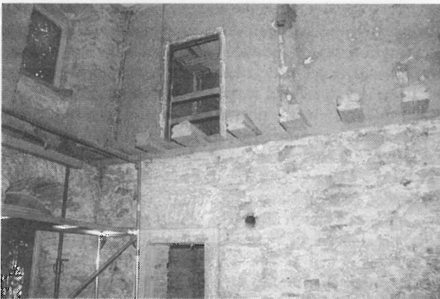
Die vom Hausschwamm befallenen Holzbalken müssen erneuert werden (Foto: Rieß).
