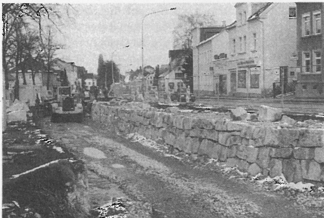
An der Hauptstraßenseite ist die Steinmauer bis zur Höhe der Firma Keilau verlegt.
